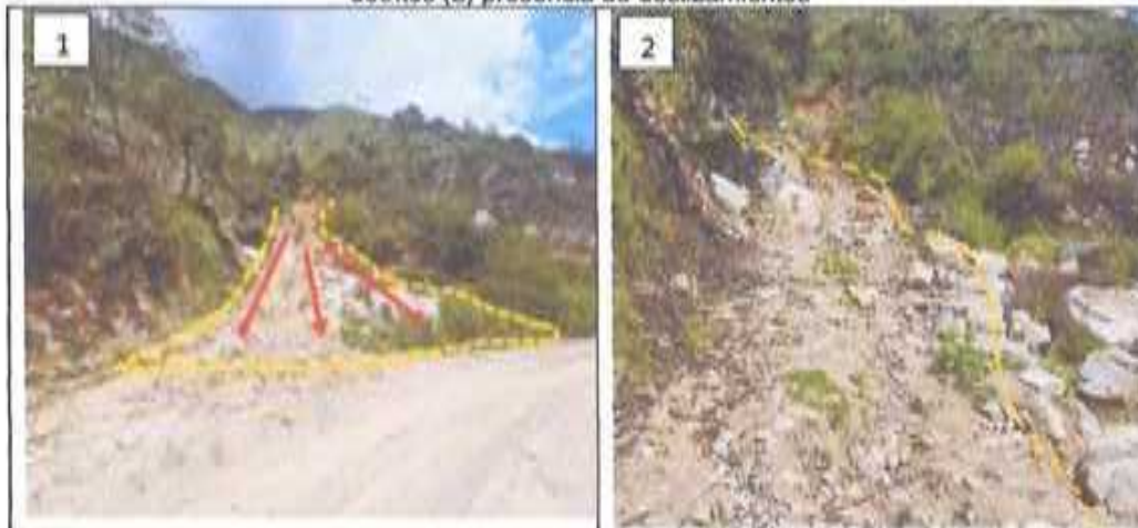
Figura N° 73. Panel fotográfico zona crítica 23, vía vecinal LM-571 (1) presencia de flujo de detritos (2) presencia de deslizamientos
