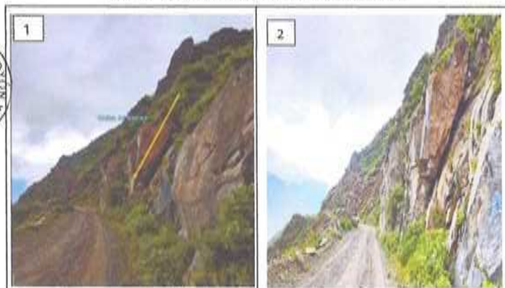
Figura N° 77. Presencia de deslizamiento y caída de rocas
