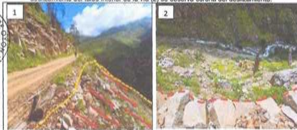
Figura N° 71. Panel fotográfico zona crítica 22, Ruta vecinal LM-571, Emp. PE-18 - Choques - Quilca - Colcapampa - Bellavista - Cochamarca - Pta. Carretera (Km 16 +000) (1) se observa deslizamiento del talud inferior de la vía (2) se observa corona del deslizamiento.
