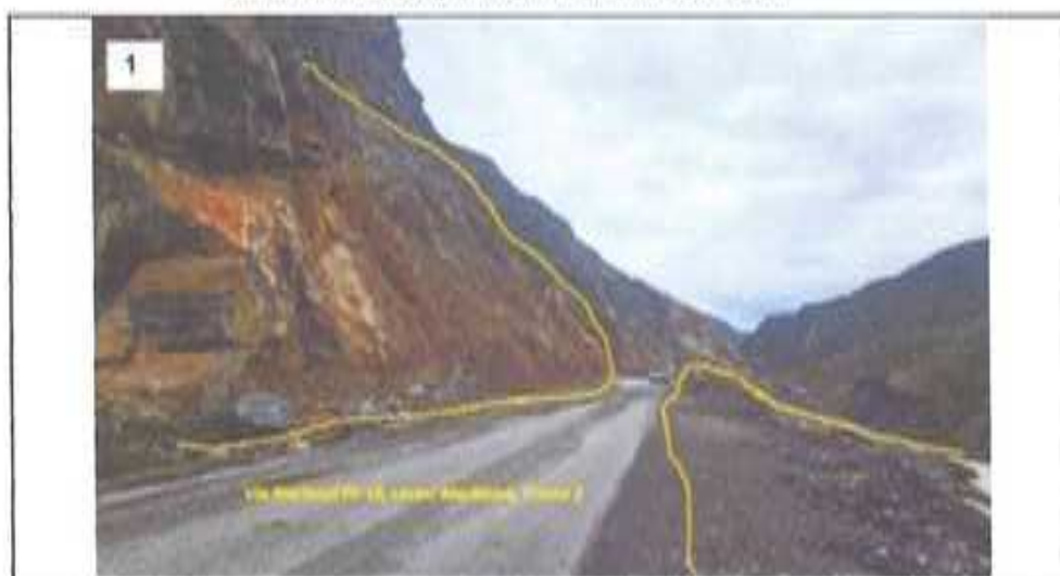
Figura N° 33. Caída de rocas sobre la plataforma de la vía nacional PE-18; (1) inicio del tramo de caída de rocas, (2) tramo final de caída de rocas.
