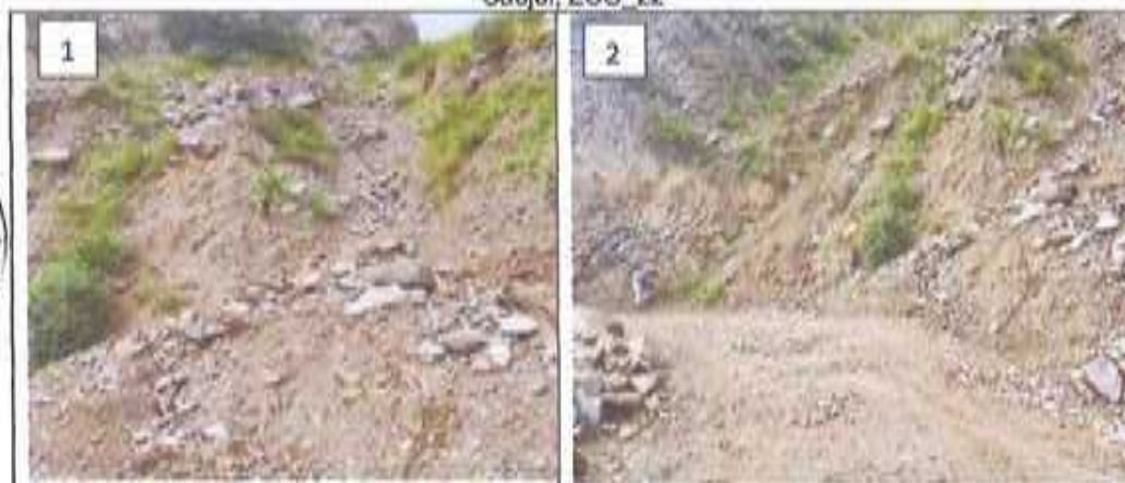
Figura N° 69. Panel fotográfico zona crítica 22, Carretera Aguar -Caujul 7.65 km desde Desvío Caujul, ZCO_22
