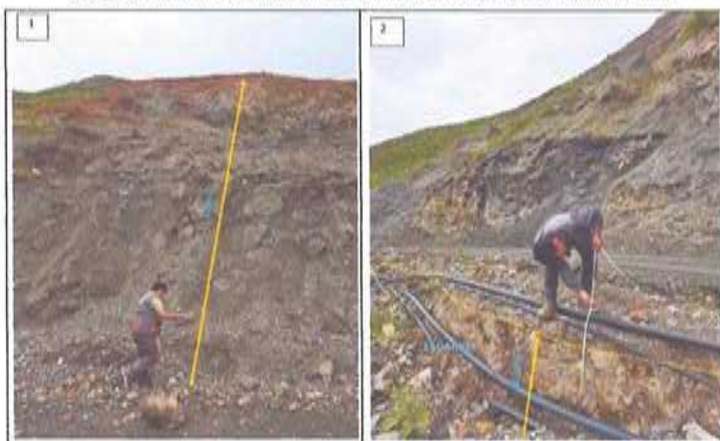
Figura N° 83. Peligro de deslizamiento en la zona crítica (1) cuerpo del deslizamiento aprox. 15 metros, (2) tubería de canal de riego espuesta (3 y 4) presencia de material suelto
