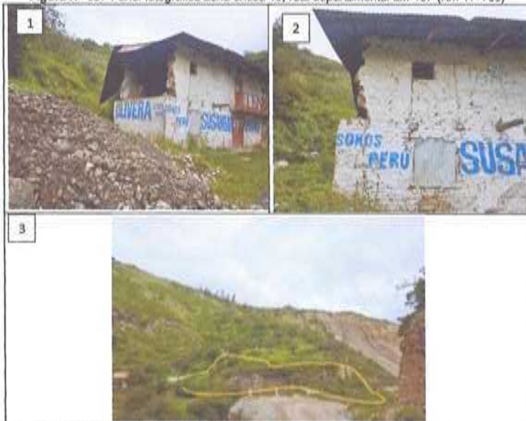
Figura N° 63. Panel fotográfico zona crítica 19, ruta departamental LM-107 (Km 11+700)
