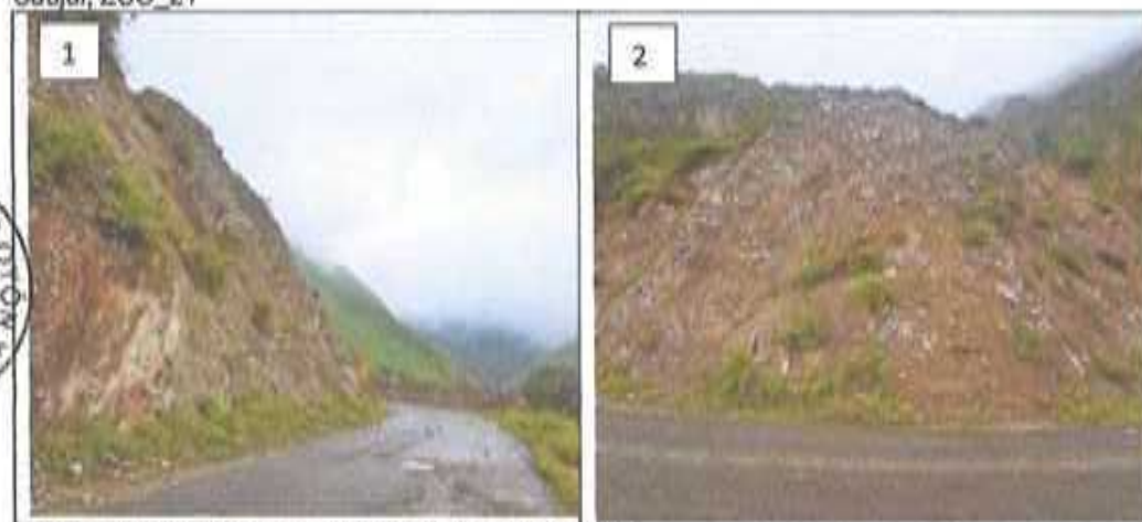
Figura N° 67. Panel fotográfico zona crítica 21, Carretera Aguar -Caujul 7.7 km desde desvío Caujul, ZCO_21
