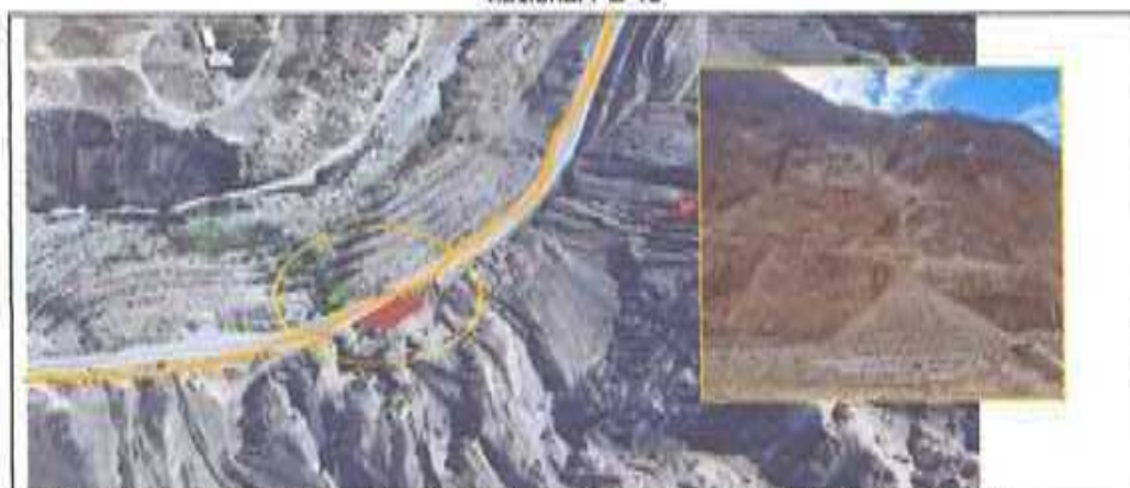
Figura N° 56. Delimitación de peligros de deslizamiento superficial en el km 106+700 de la ruta nacional PE-18
