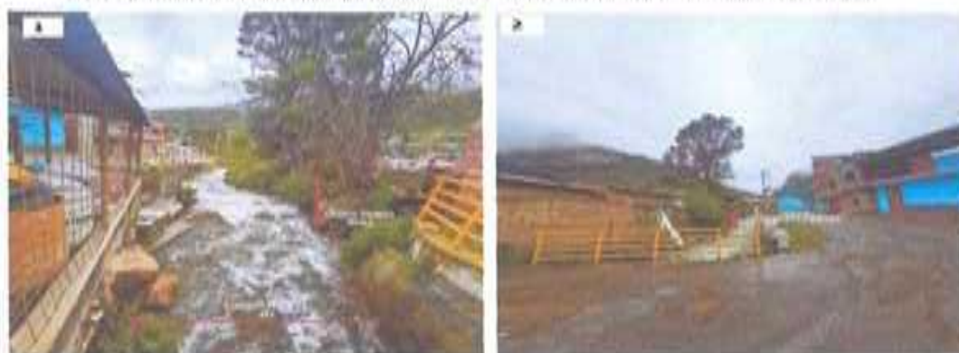
Figura N° 45. Panel fotográfico de elementos expuestos y peligro de inundación fluvial; (1) socavamiento de muro ciclópeo y borde libre menor a 50cm, (2) Viviendas expuestas.
