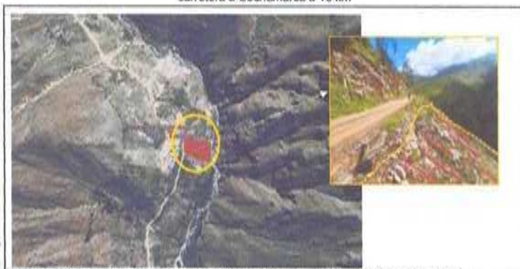
Figura N° 70. Delimitación de peligros de deslizamiento superficial de suelo detritos en la carretera a Cochamarca a 16 km
