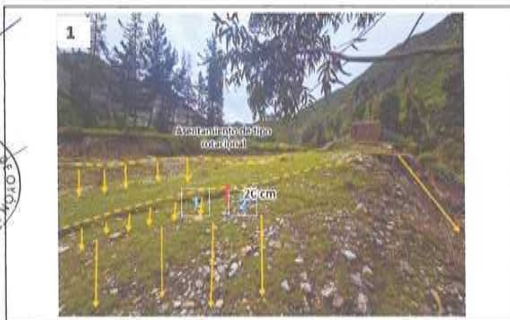
Figura N° 37. Indicios del deslizamiento; (1) asentamiento con escarpes, (2) fisura en vivienda
