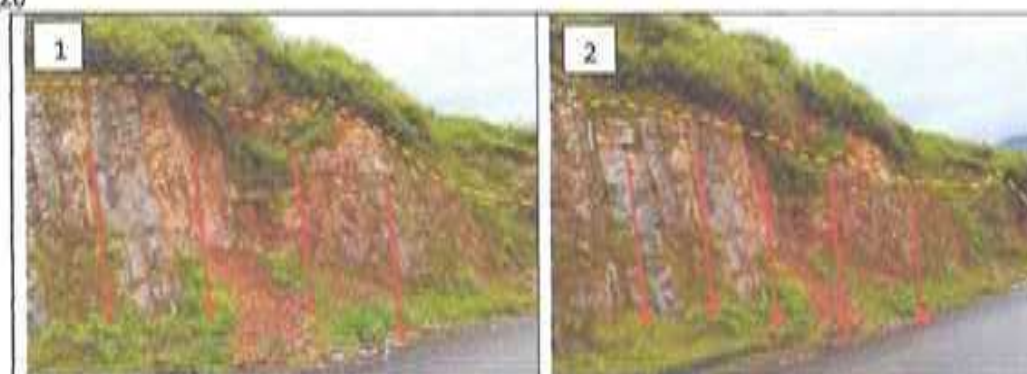
Figura N° 65. Panel fotográfico zona crítica 19, Carretera Aguar -Caujul 17.7 km desde desvío Caujul, ZCO_20
